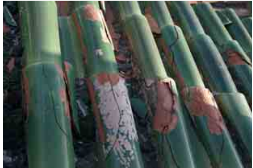
Les teules presentaven un significatiu deteriorament
