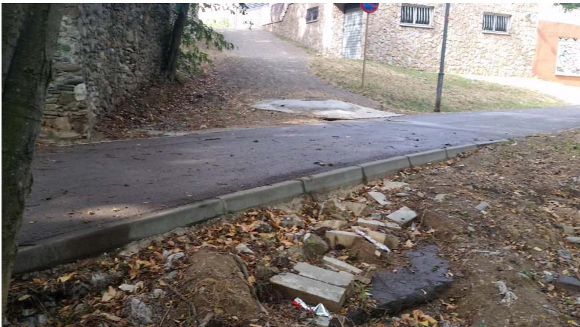
Punt de creuament de l'escorrentiu superficial sobre el carril bici. Inici del soscavament per acció de les aigües. Punt on es preveu la formalització de l'interceptor protegit amb baranes.
