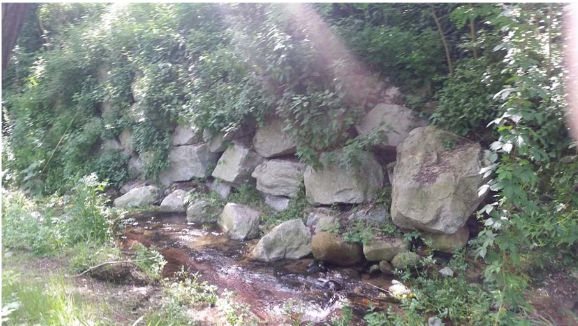
Zona situada aigües amunt de l'àmbit de l'Estudi. Escullera existent construïda per l'Ajuntament per protecció del marge.
