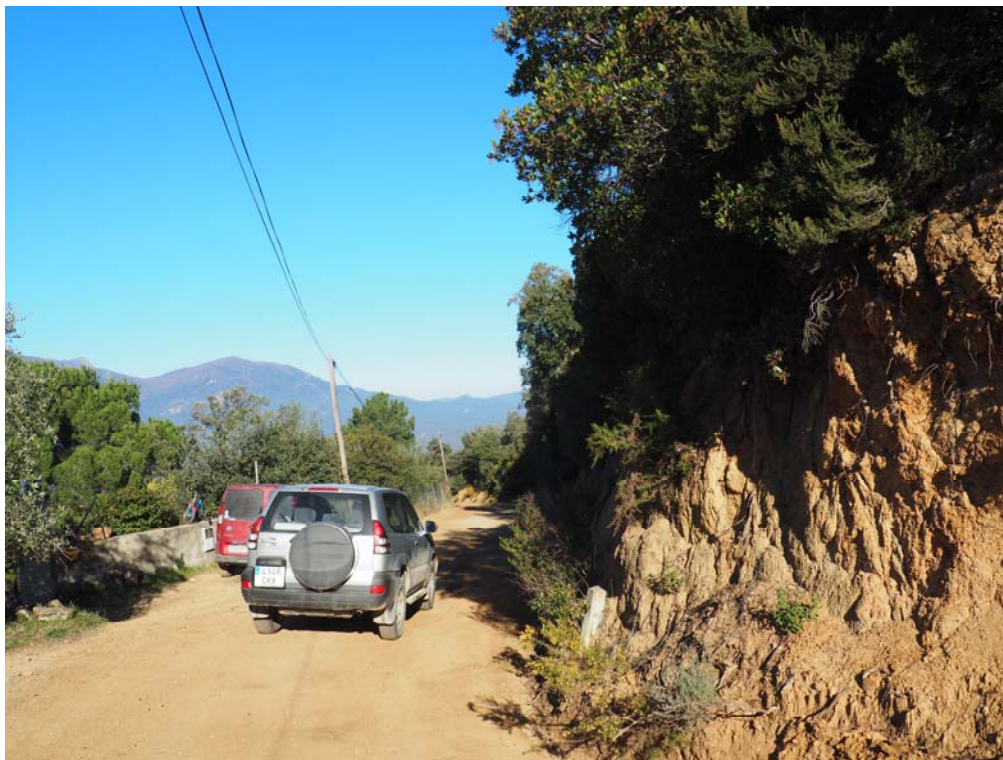
Fotografia 4. La major part dels carrers sense asfaltar presenten talussos de poca alçada, oberts en granodiorites. Les inestabilitats que es poden observar són de molt poca entitat, procedents de la pròpia alteració superficial de les granodiorites.
