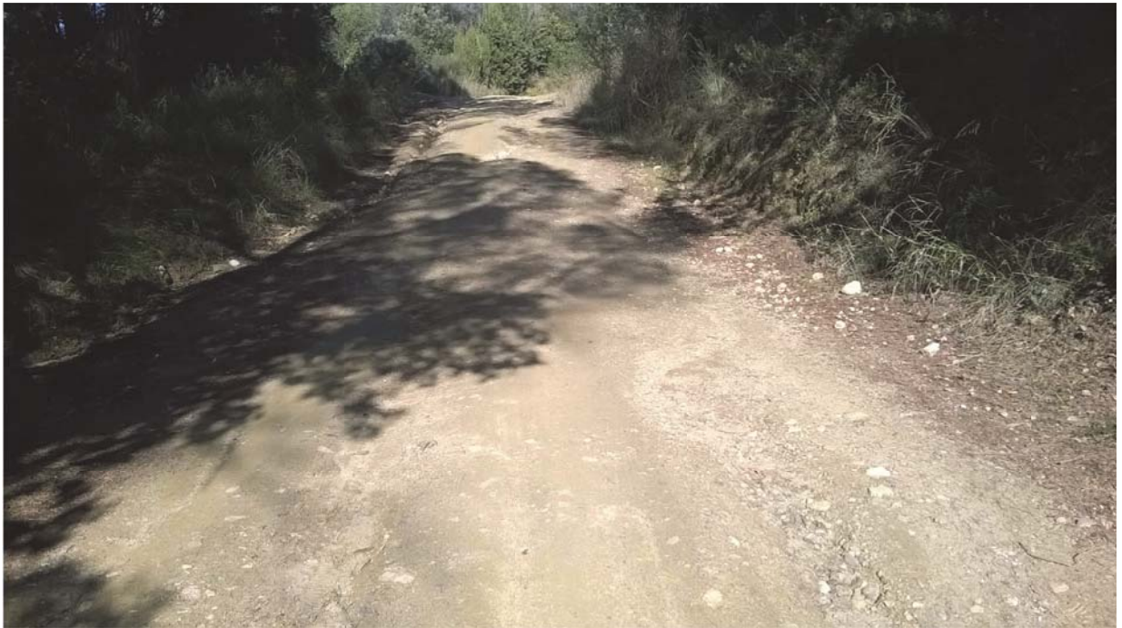
Foto 49. Continuació del camí de Campins. PK 1+240. Tram en pitjor estat.
