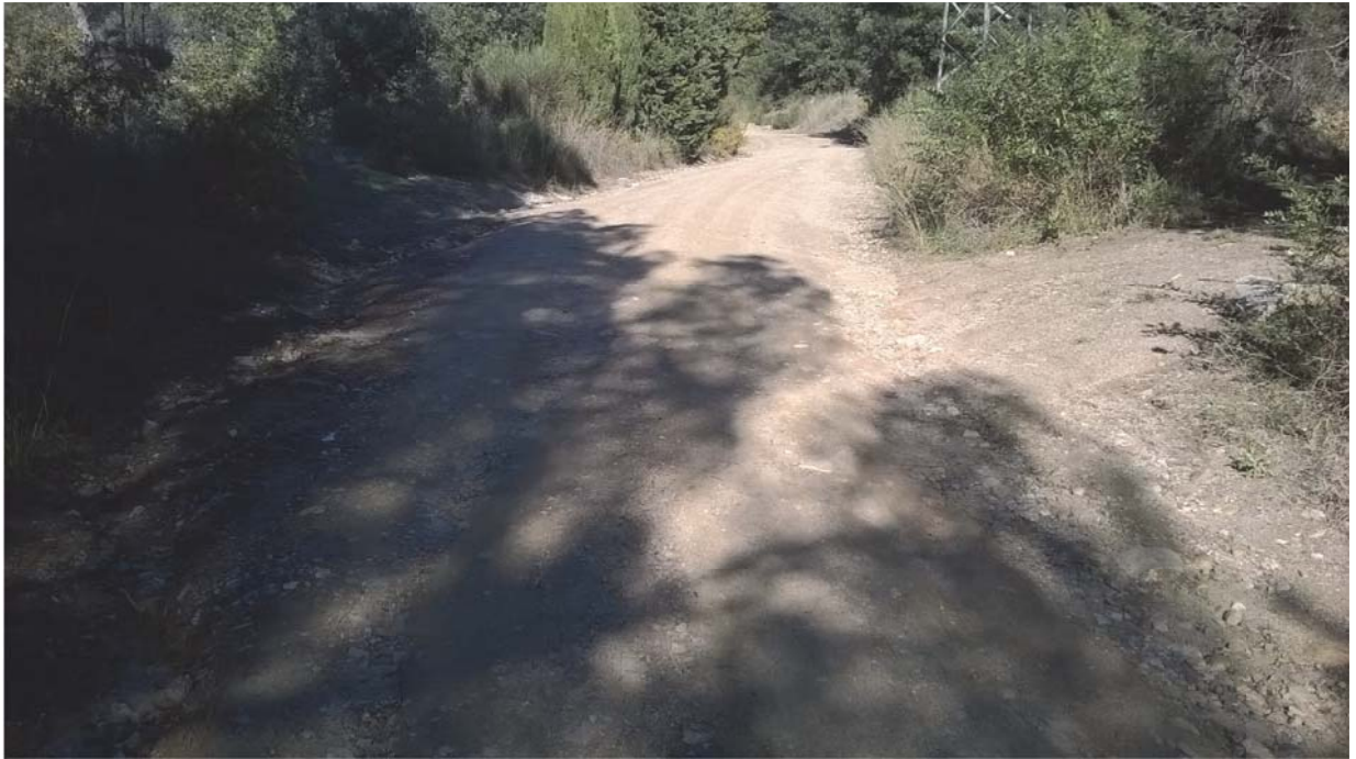
Foto 51. Continuació del camí de Campins. PK 1+280. Tram en pitjor estat.
