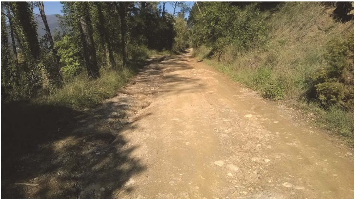
Foto 44. Continuació del camí de Campins. PK 1+120. Tram en mal estat.
