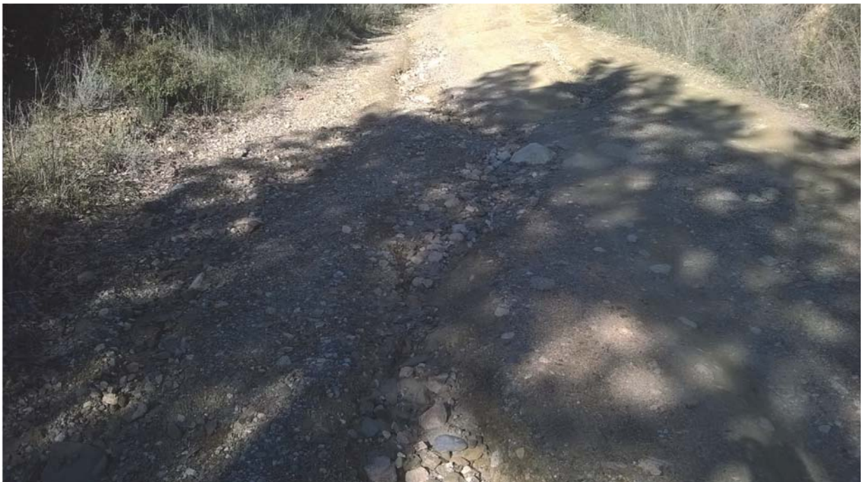
Foto 40. Continuació del camí de Campins. PK 0+980. Tram en mal estat.
