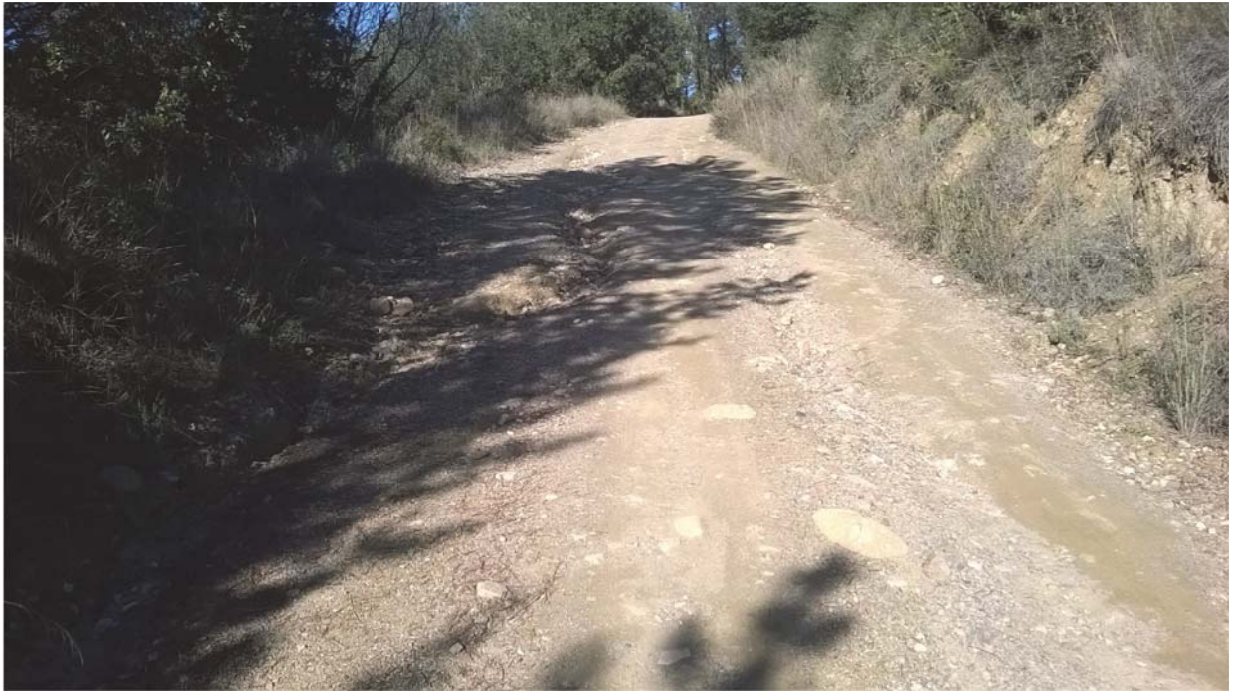
Foto 39. Continuació del camí de Campins. PK 0+960. Tram en mal estat.
